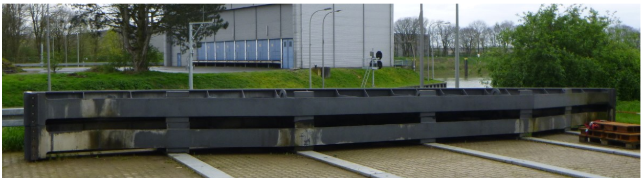
Abbildung 1 Foto 2 Dammbalken aufeinandergestapelt
