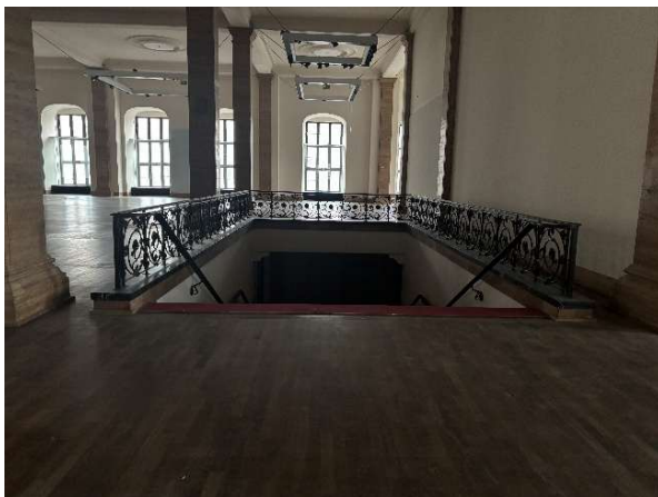
Schutz Treppengeländer OG
