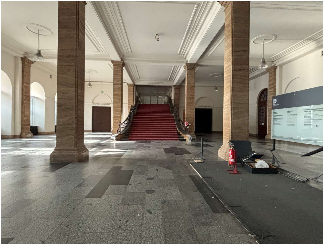
Eingangshalle Schutz Treppengeländer und Treppenanlagen
