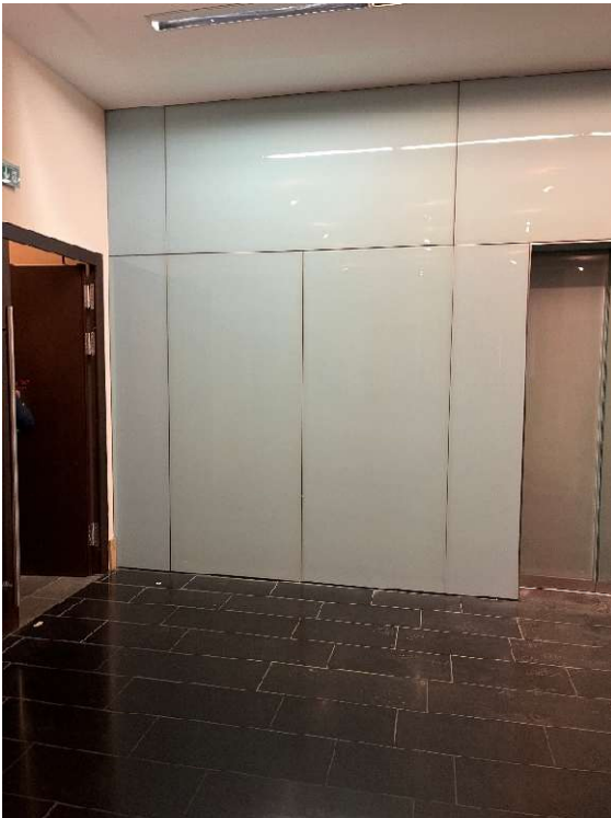
Wandverkleidung Glas, Garderobenbereich
