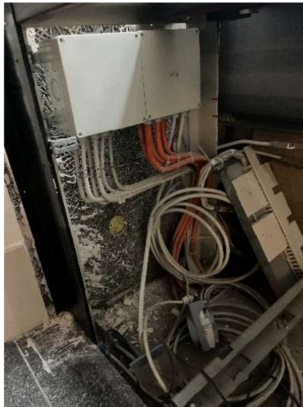
ELT Leitungen im Bereich NKG
