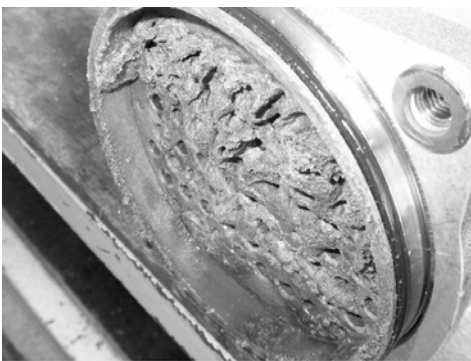
Abb. 27: Fouling: Organische Ablagerungen am Rohrbündel verursacht durch geringe Strömungsgeschwindigkeit und lange Stillstandszeit (Beispiel)
