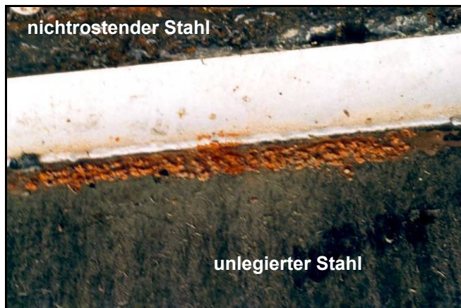
Bild 3: Beschichtungs- und Korrosionsschaden an einer Stauklappe
