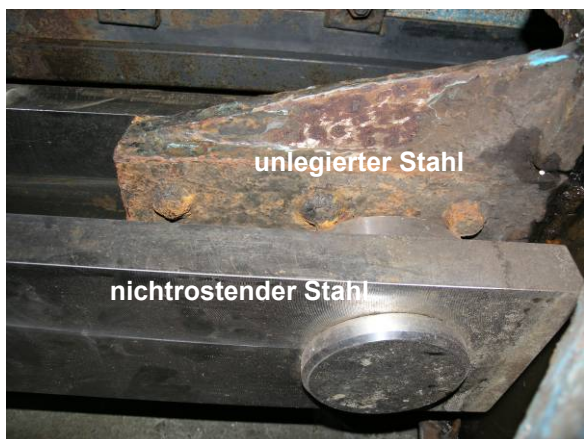
Bild 6: Korrosion am unlegierten Stahl infolge des nichtrostenden Bolzen und der nichtrostenden Zahnstangen
