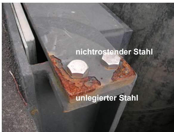
Bild 5: Korrosion am unlegierten Stahl infolge von nichtrostenden Schrauben
