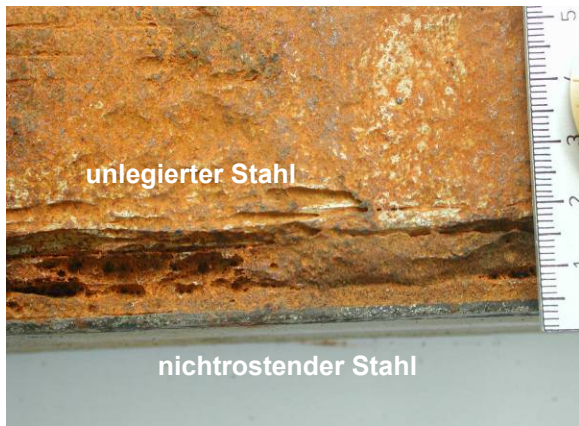
Bild 4: Korrosion am unlegierten Stahl infolge einer Aufplattierung aus nichtrostendem Stahl
