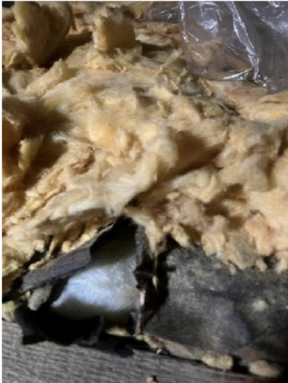
Proben-Nr. 45: OG, Dachboden, Dämmung "hell" KMF (Glaswolle) nachgewiesen
