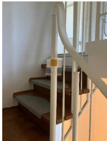
Proben-Nr. 51: EG, Flur, Treppengeländer, Anstrichstoff Blei: 81000 mg/kg, Zink: 21000 mg/kg
