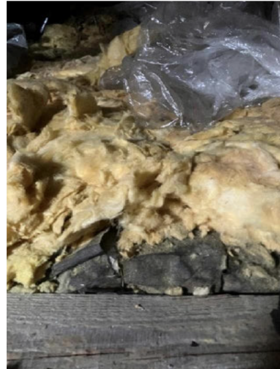
Proben-Nr. 46: OG, Dachboden, Dämmung "gelb" KMF (Glaswolle) nachgewiesen
