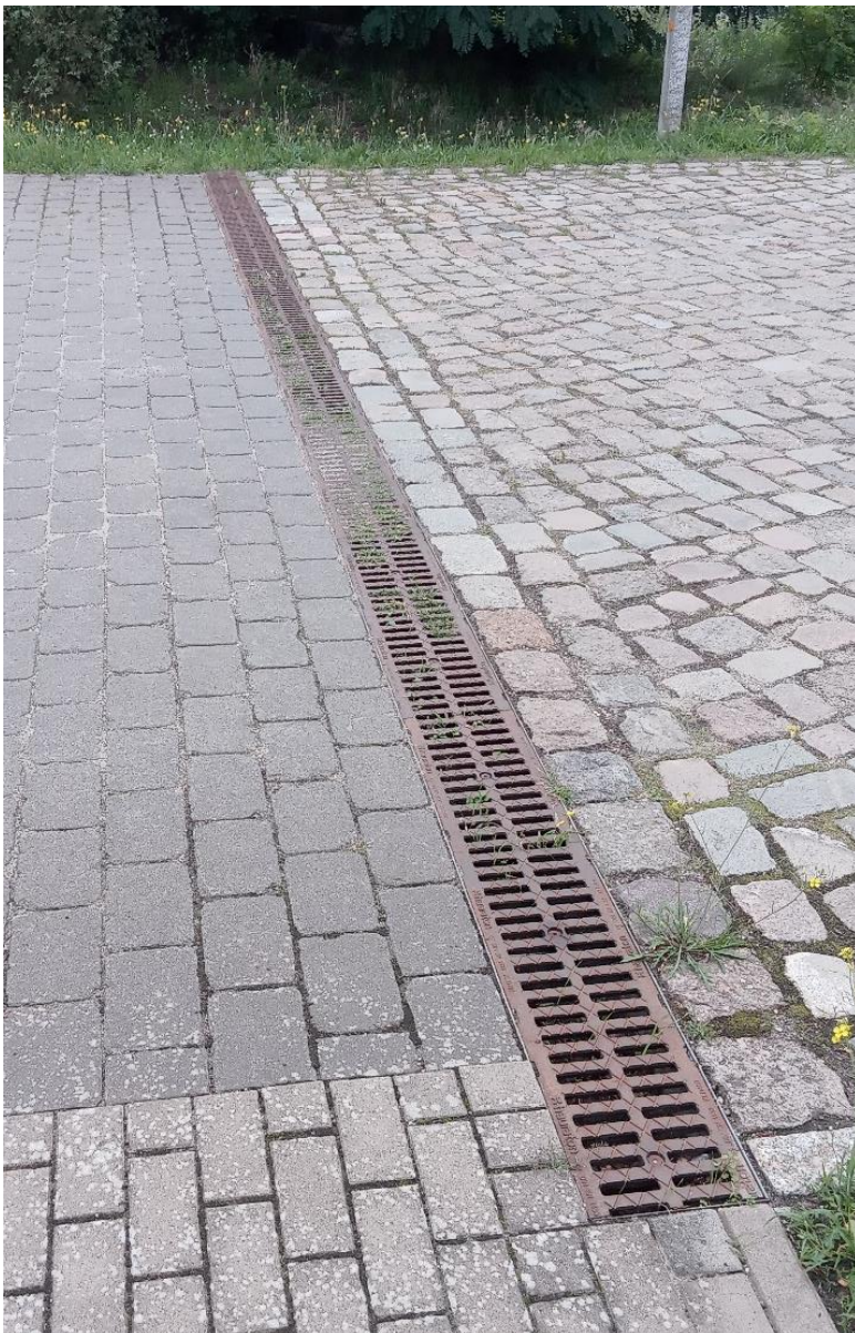
Entwässerungsrinne (mit montierter Gitterabdeckung) vor Haupttor
