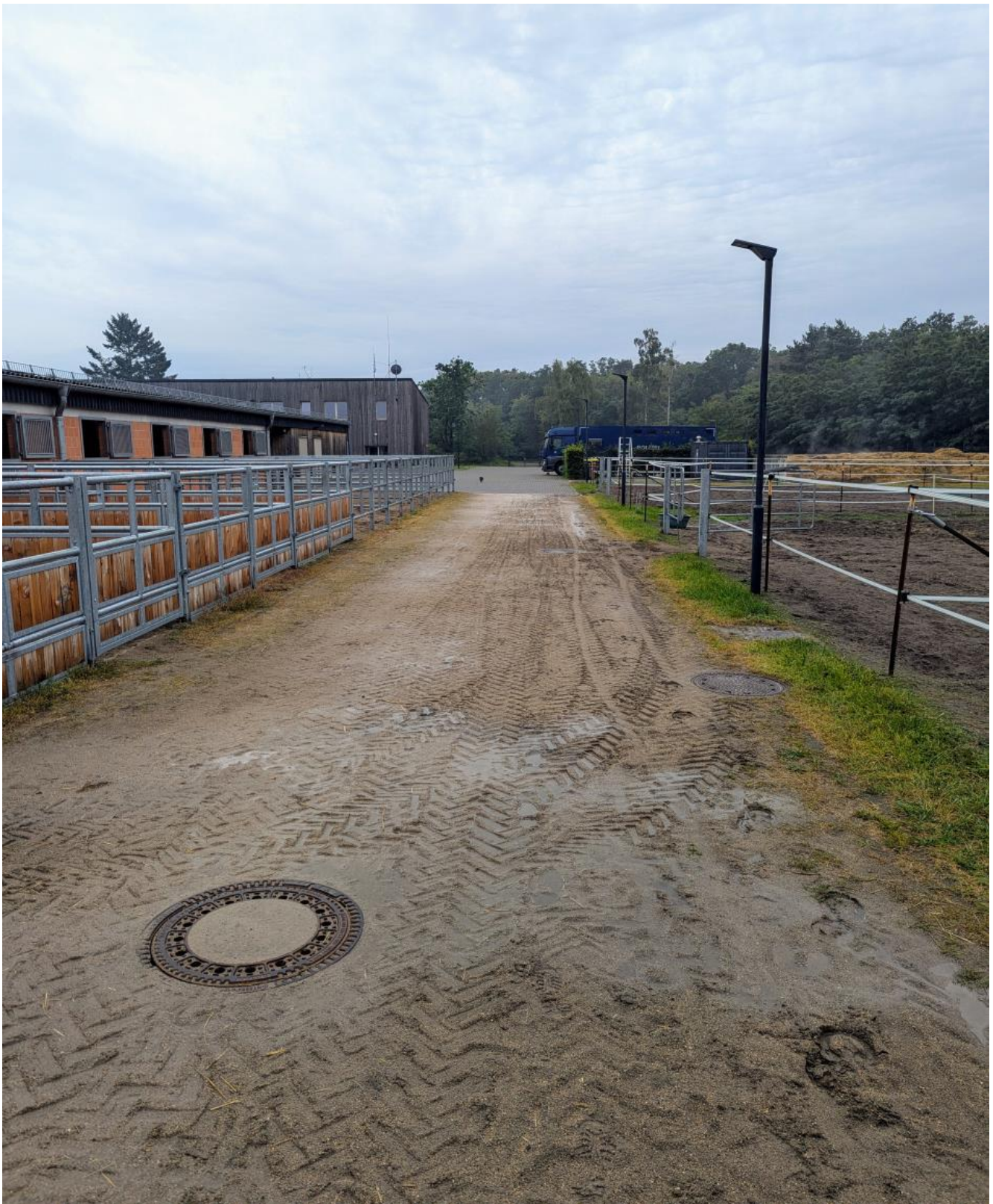
Gullys am Stallgebäude links an den Koppeln (Sandweg)
