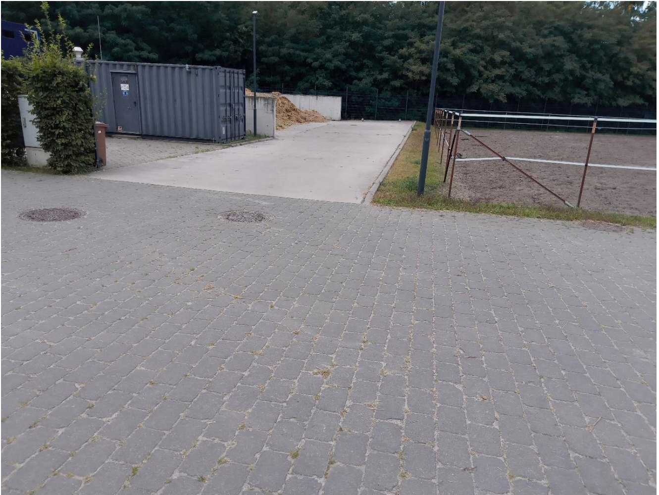
Gullys Bereich Müllplatz / Zufahrt Dunglager / erst Teilkoppel
