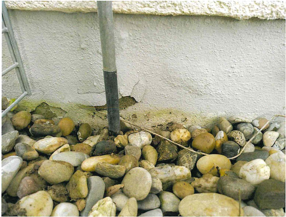
Bild 03 a: Sockel - Südseite, außen Am Sockelputz Abplatzungen und Aufwölbungen, also Hohlstellen
