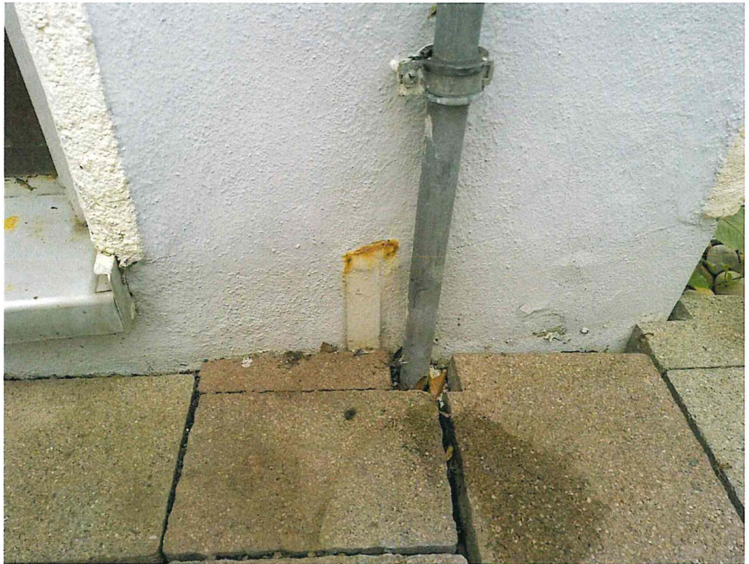
Bild 02 a: Südwestecke - Wohnzimmer, außen deutliche Rostspuren am ehemals verzinkten Fundamentanker.
