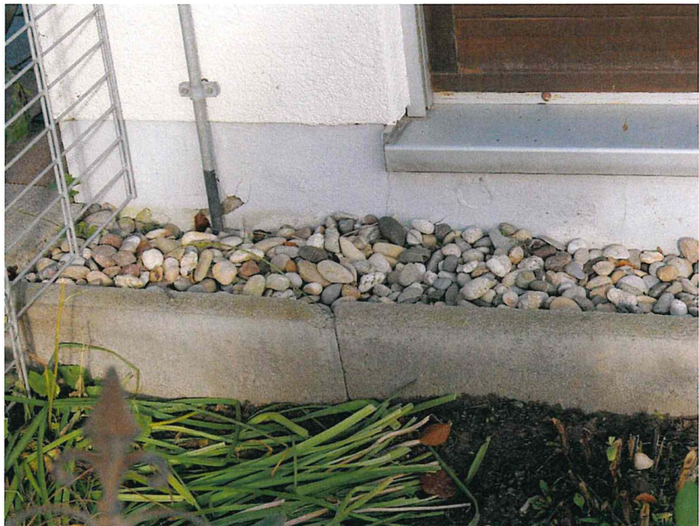
Bild 03 b: Sockel - Südseite, außen Am Sockelputz Abplatzungen und Aufwölbungen, also Hohlstellen
