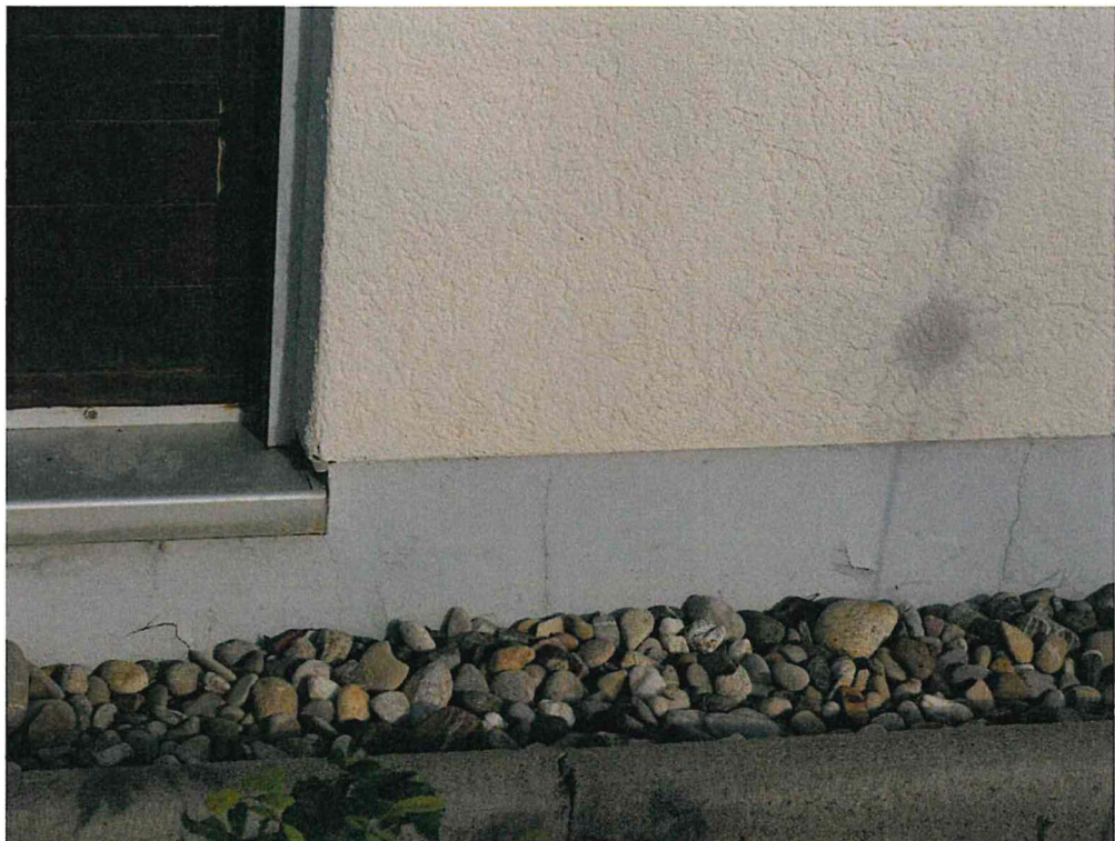
Bild 04 b: Sockel - Südseite, außen Am Sockelputz Abplatzungen und Aufwölbungen, also Hohlstellen
