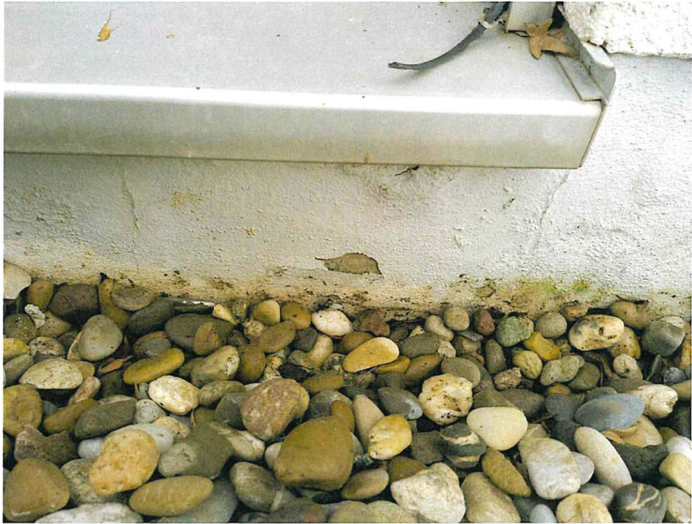
Bild 04 a: Sockel - Südseite, außen Am Sockelputz Abplatzungen und Aufwölbungen, also Hohlstellen
