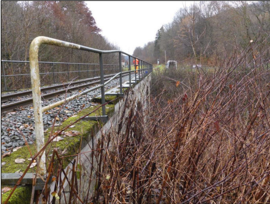
Bild 5: Setzungserscheinung an der gegenüberliegenden Flügelwand. Gilt ebenfalls für beide Flügelwände in Richtung Eisfelder Talmühle.
