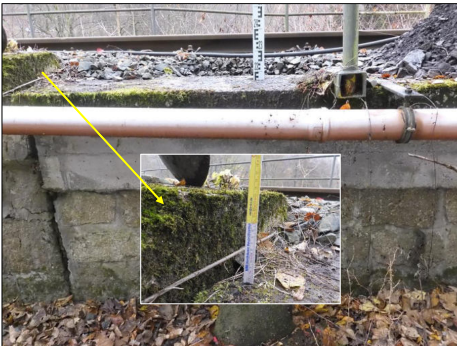
Bild 4: Setzung der Flügelwand gegenüber der Brücke, Richtung Nordhausen bei KB 6
