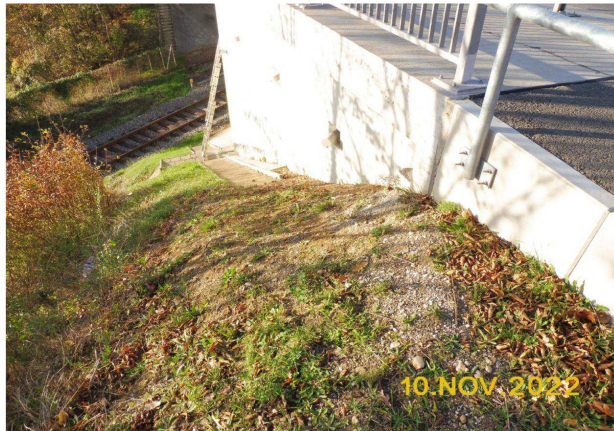
2022H2-149-BÖSCHUNGSTREPPE FEHLT TEILWEISE
