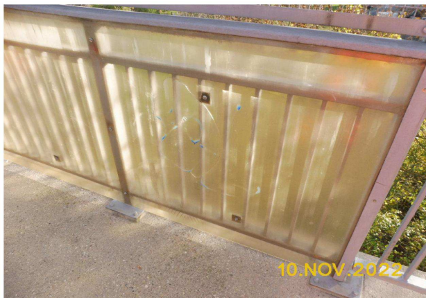
2022H2-072-GELÄNDER FÜLLUNG BESCHÄDIGT
