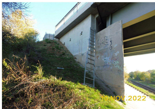
2022H2-095-FLÜGEL EINPFLASTERUNG FEHLT TEILWEISE
