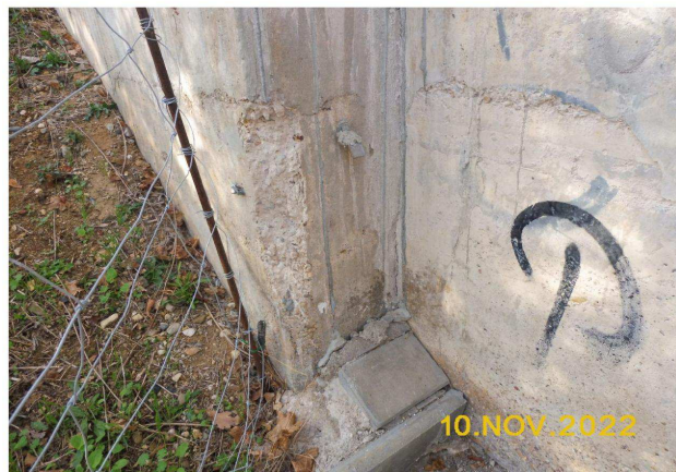
2022H2-WL HINTEN LINKS ABPLATZUNG
