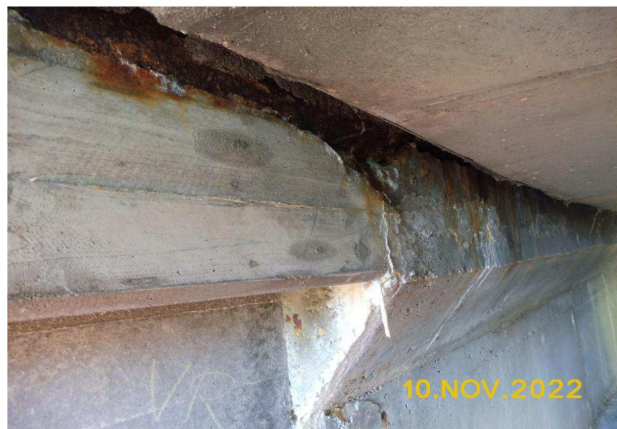
2022H2-146-FÜK VORN UNDICHT ROST
