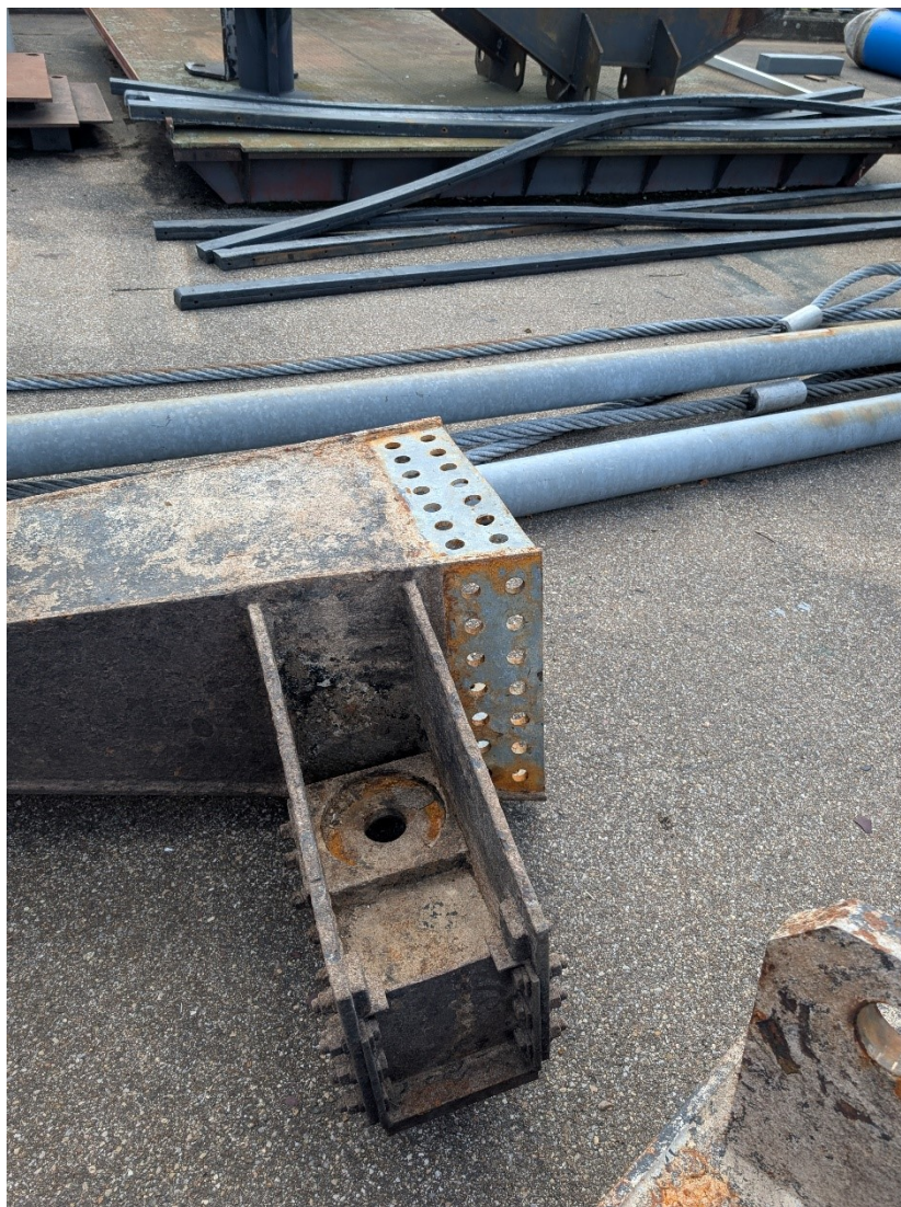
Abbildung 3: Beschädigter zweiter Torarm nach fast unmöglicher Demontage
