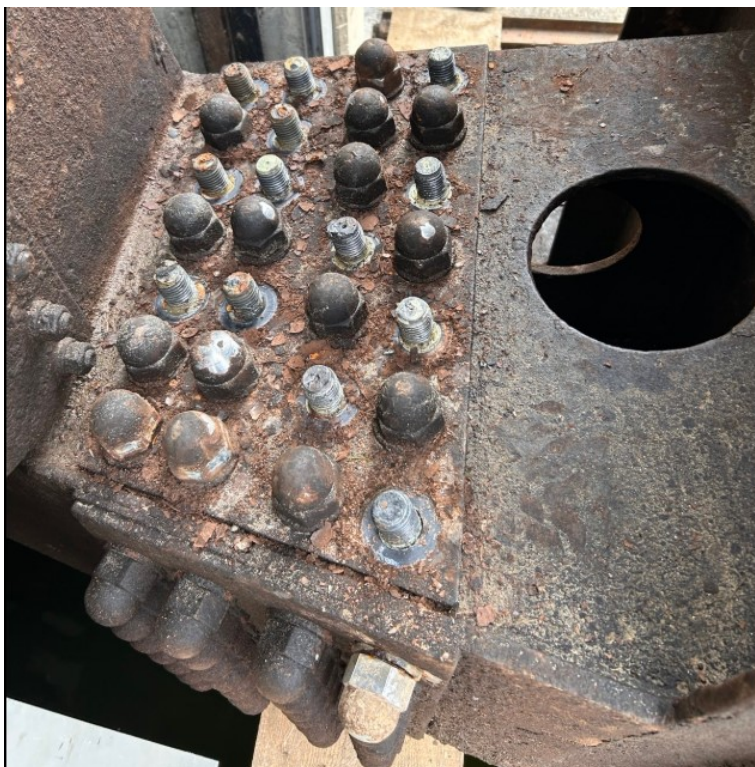
Bild 1: teilgelöste Verbindung Torarm –Obertor Schleuse Regensburg
