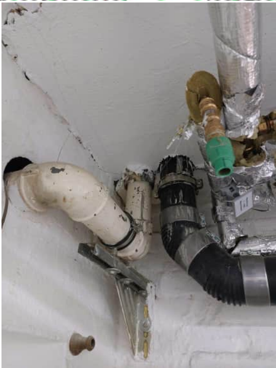
weiße Leitung Trockensteigeleitung
