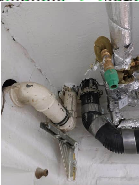
weiße Leitung Trockensteigeleitung
