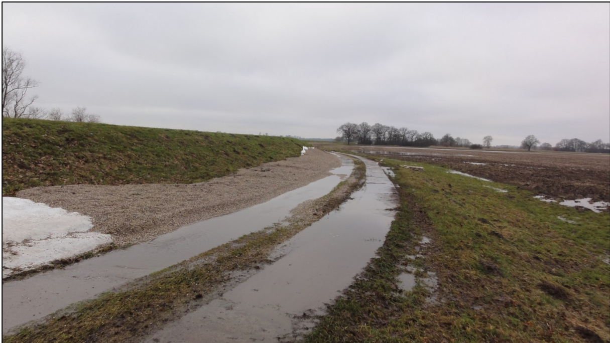
Abbildung 1: Sickerwasseraustritt beim HW 01/2011 [Quelle: PPN]
