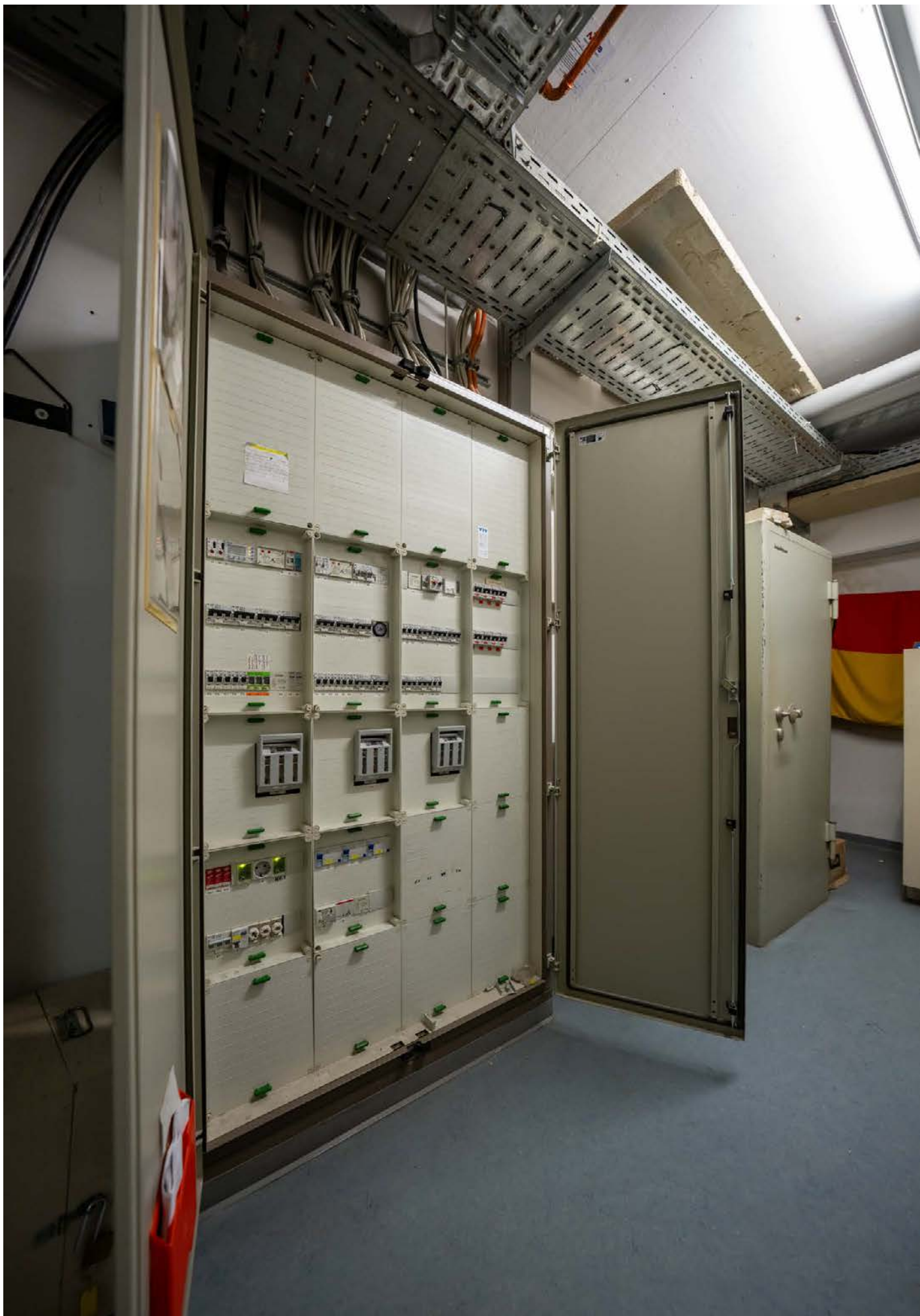
Ansicht Verteilerschrank Beleuchtung Tiefgarage Bestand
