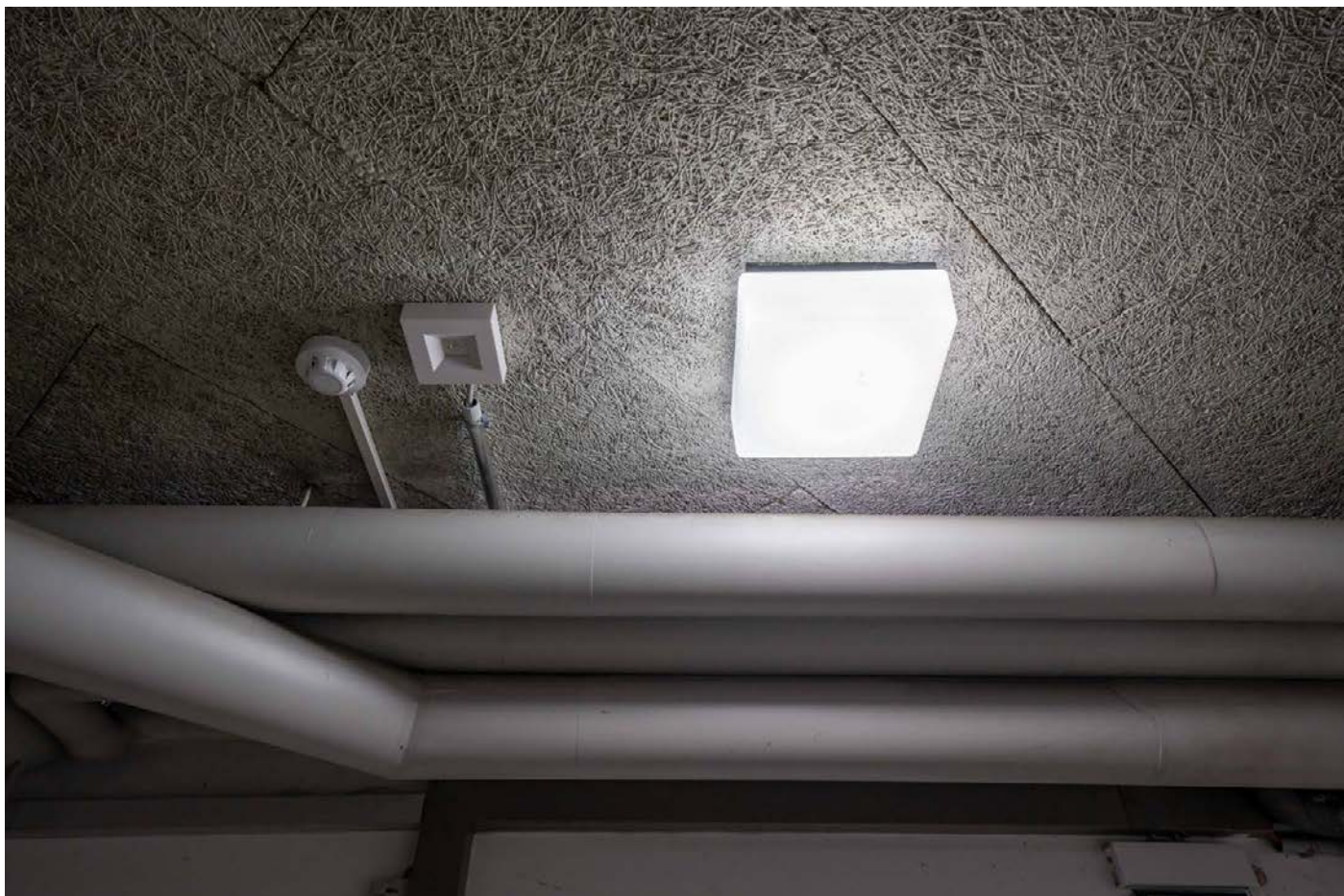
Beispiel Ansicht Bestandsleuchte Vorraum Treppenraum KG
