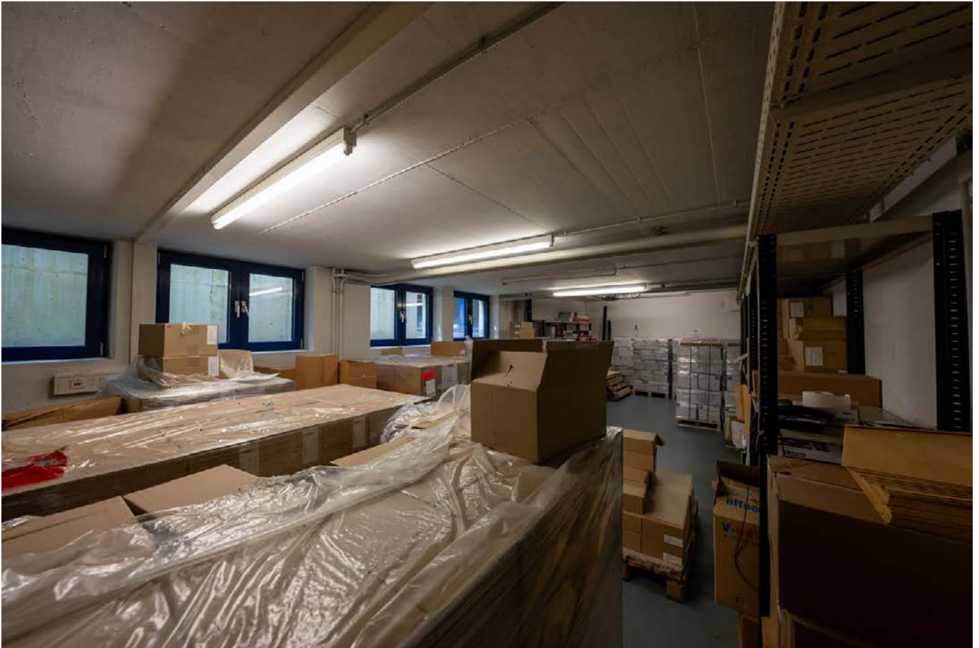
Beispiel Ansicht Technikraum KG
