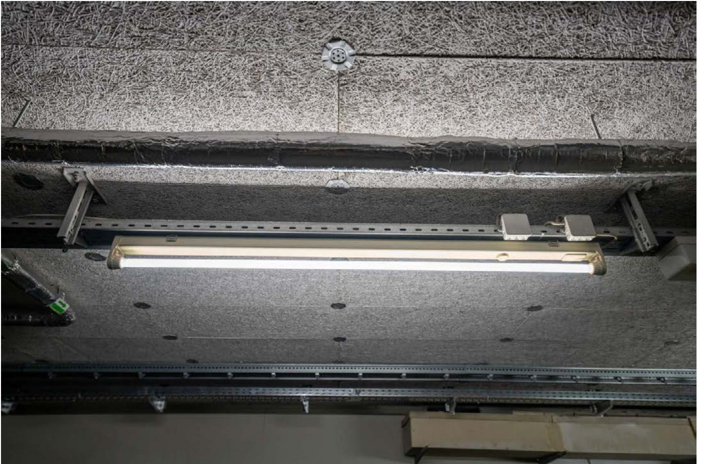
Beispiel Bestandsleuchte Parkdeck
