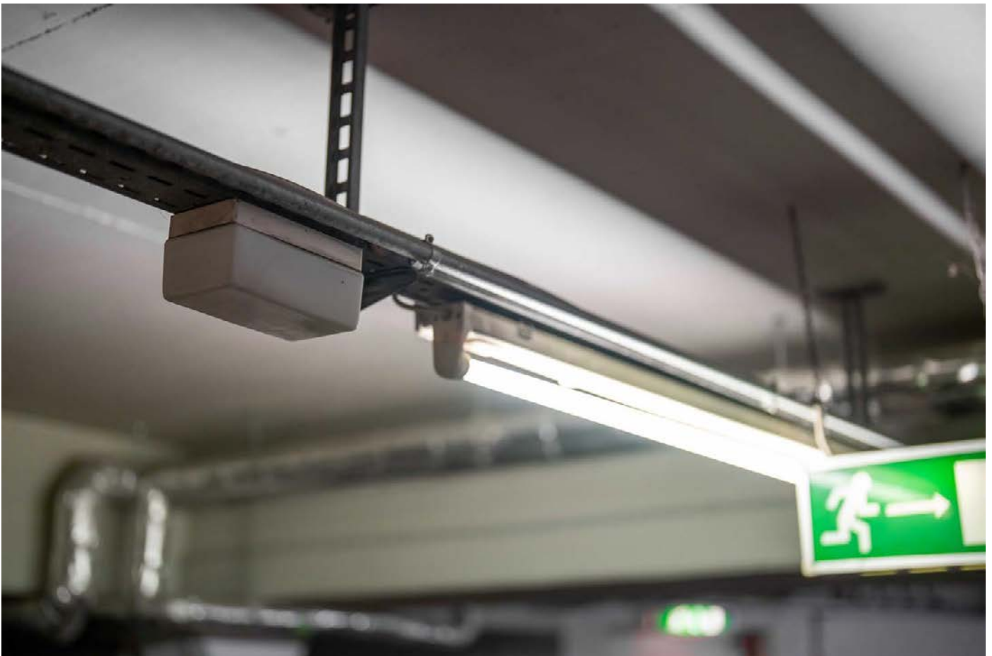
Beispiel Bestandsleuchte Sicherheitsbeleuchtung Parkdeck
