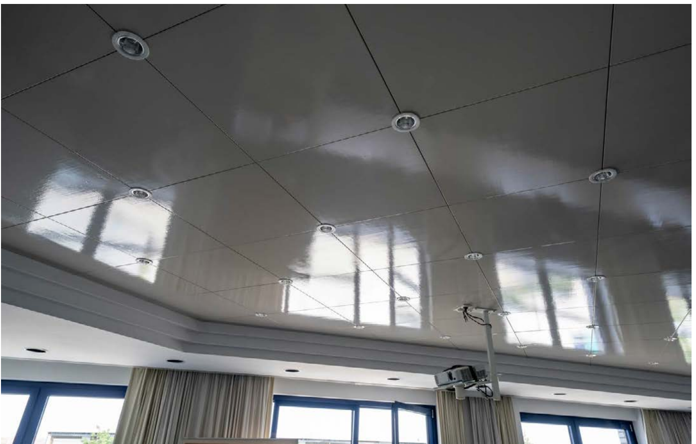
Ansicht Einbauspots Sitzungssaal in Sonderdecke Zentrum
