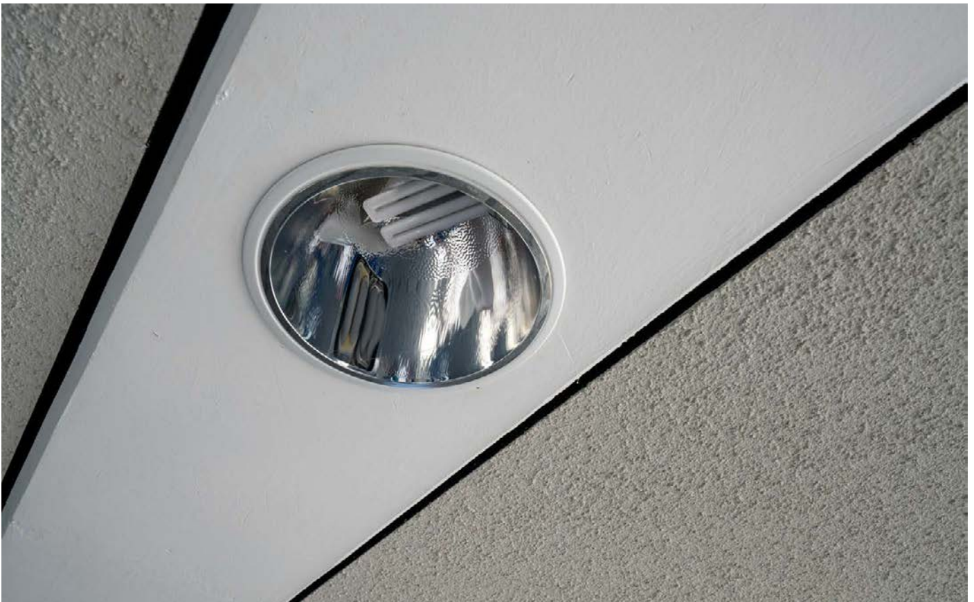
Ansicht Standardeinbauleuchte Foyer in Trockenbaustreifen
