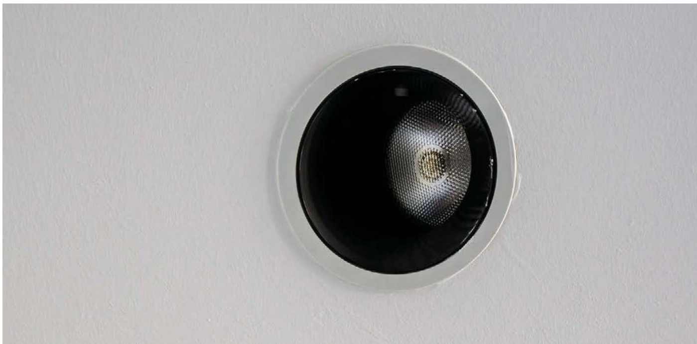
Beispiel Einbauspot Sitzungssaal Randbereich
