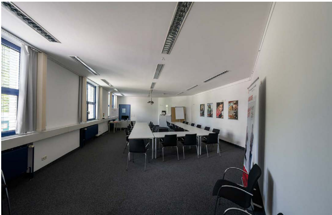
Ansicht Schulungsraum BIZ mit Einbauleuchten in Lagfeldbauweise
