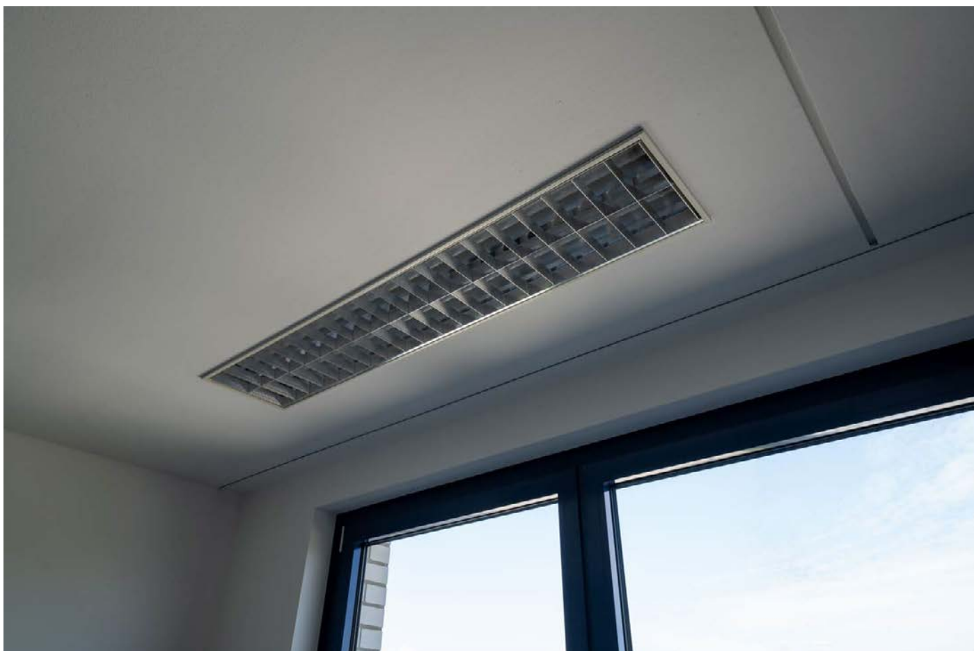
Ansicht Beispiel Einbauleuchten Büros
