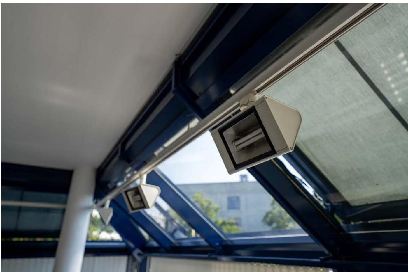
Detailansicht Akzentbeleuchtung BIZ
