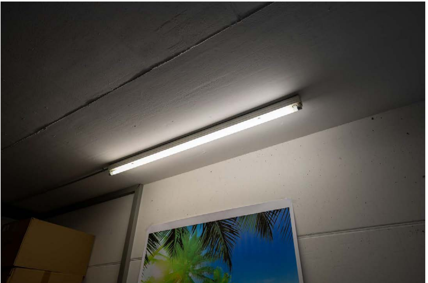
Beispiel Ansicht Bestandsleuchte Technikraum KG
