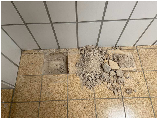
keine Dichtung unter Estrich
