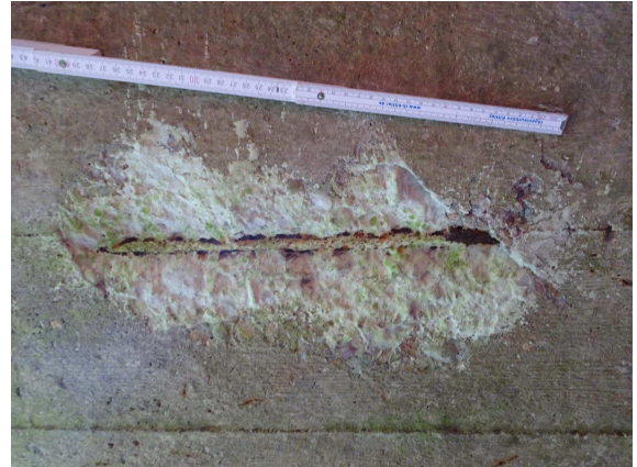
S03 FREIL BEWEHRUNG AN PLATTENUNTERSEITE
