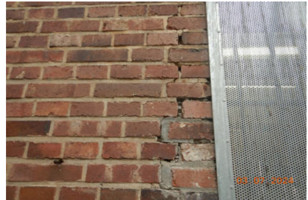
4. Abplatzung an Mörtelfuge
