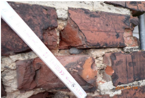
3. Verankerung liegt frei
