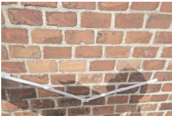
Oberfläche verwittert mit Abplatzung
