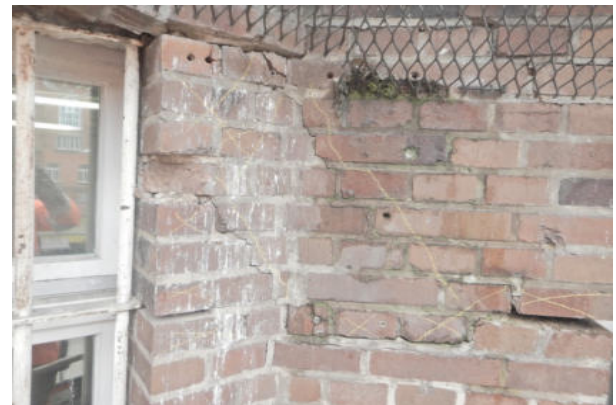
4. Rissverlauf mit lockeren Steinen
