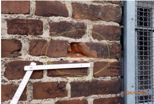
1. Verankerung liegt frei
