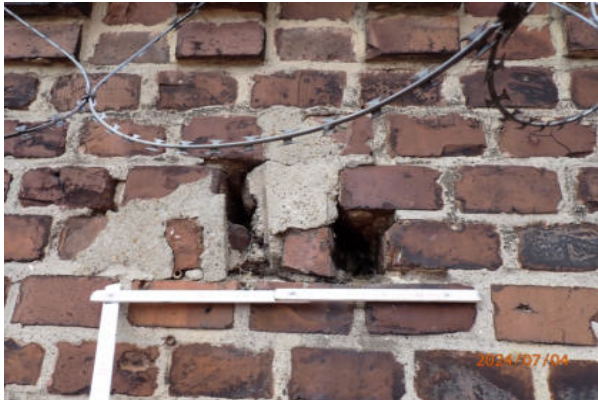
1. Lücke in der Fassade
