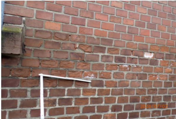
1. Oberfläche verwittert mit Abplatzung
