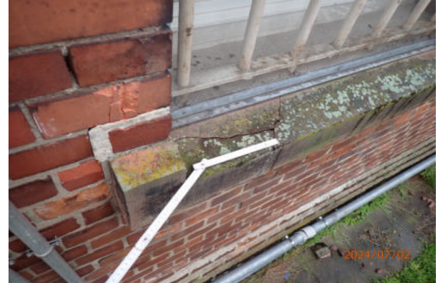
2. Fensterbank rissig und bemoost
