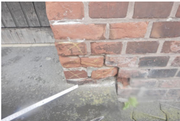
1. Riss und lockere Steine
