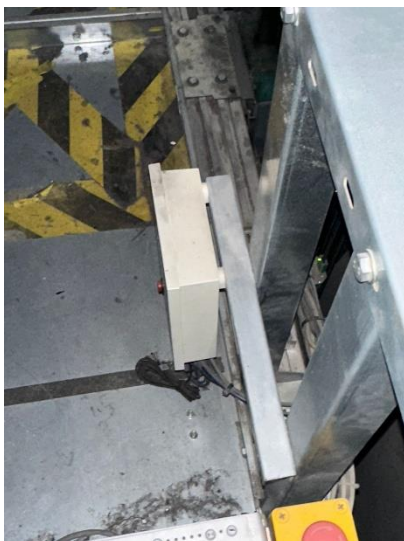
Abbildung 2: beispielhafte ordentliche Befestigung des Gateways auf einem Aufzug
