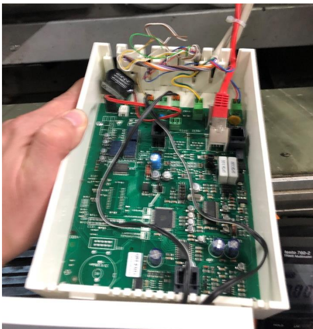
Abbildung 1: nicht fachgerechte Verkabelung
