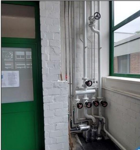
Abbildung 24: Hydraulisches System – Strangleitungen in der Werkhalle
