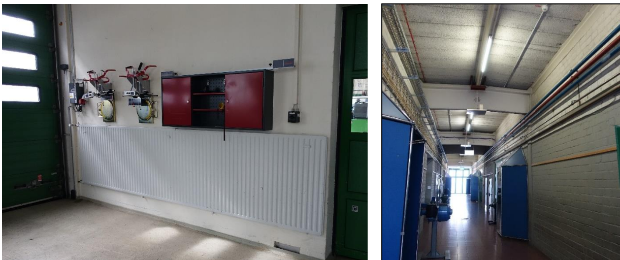
Abbildung 23: Werkhalle: Freie Heizkörper (links) / Verteilleitungen im Flur nicht gedämmt (rechts)
