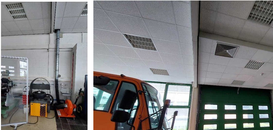
Abbildung 26: Beispiel: KFZ-Labor (N1) Abgasabsaugung (links) / Zuluft-Einlass (rechts)
