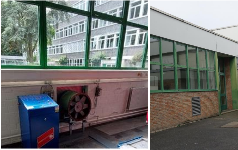
Abbildung 22: Ventilatoreinrichtung – Fahrzeugtechnik – Innenansicht / Außenansicht
