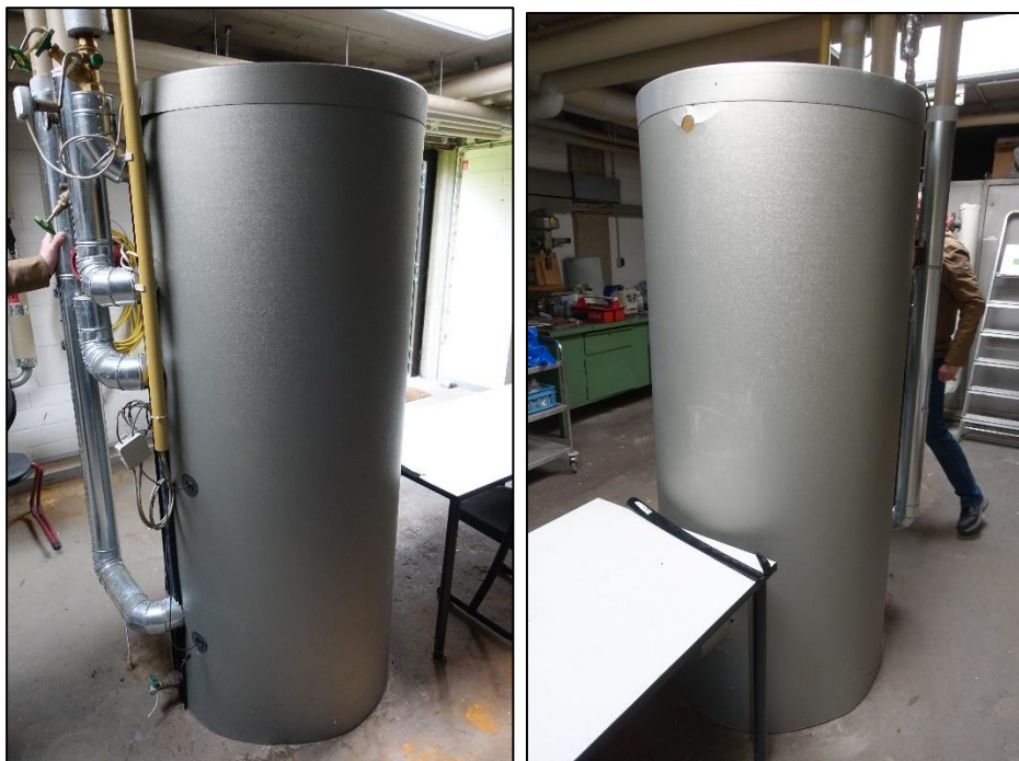
Abbildung 30: Warmwasserspeicher der Turnhalle im Technikraum
