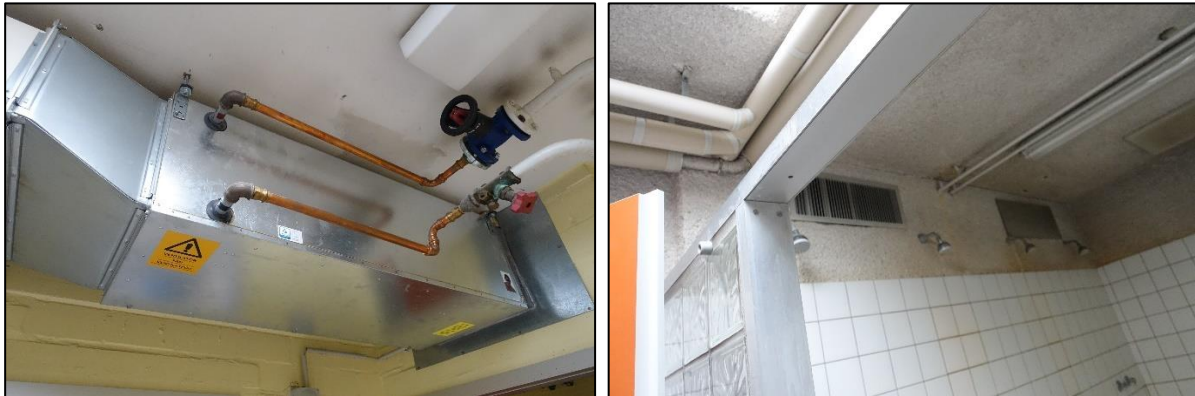
Abbildung 34: Dezentrale Lüftungsgeräte jeweils in den Umkleiden // Zuluftauslässe in den Duschräumen
