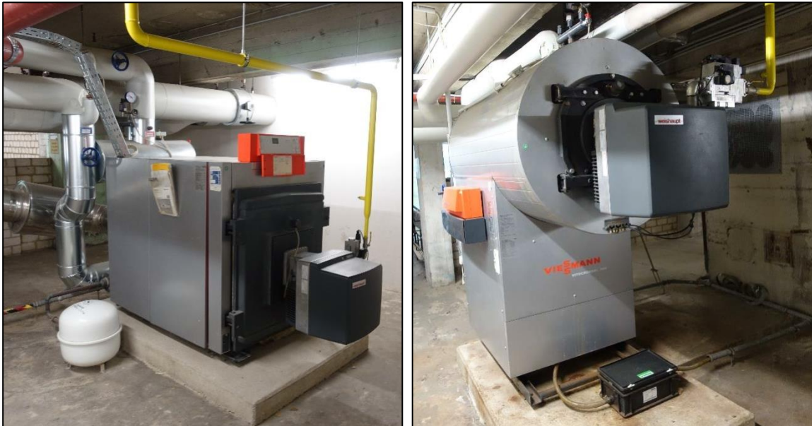
Abbildung 26: Gas-Brennwertkessel Vitorond 200 (links), Vitocrossal 300 (rechts); Standort Kellergeschoss Berufskolleg
