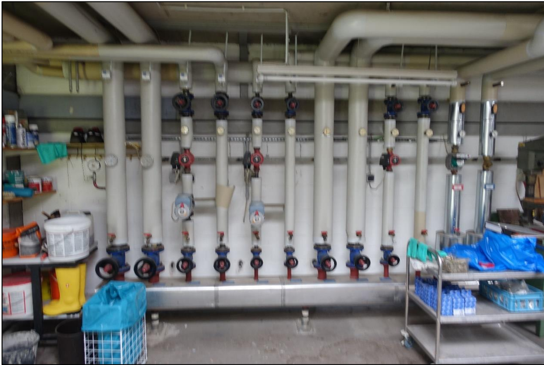
Abbildung 28: Hydraulisches System im Technikraum der Kreissporthalle
