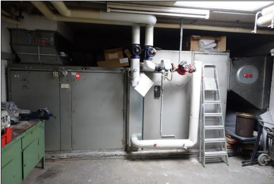
Abbildung 32: Lüftungsanlage für die Sporthalle im südlichen Technikraum
