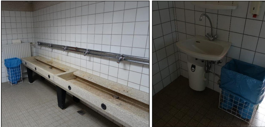
Abbildung 31: Wasserversorgung Waschbecken in den Umkleiden // Dezentrale Durchlauferhitzer in den WCs im Nebengebäude (Foyer) zur Tribüne
