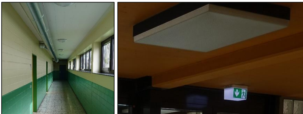
Abbildung 37: Beleuchtung Flure mit Leuchtstofflampen (links); Beleuchtung Eingang Tribüne mit LED (rechts)
