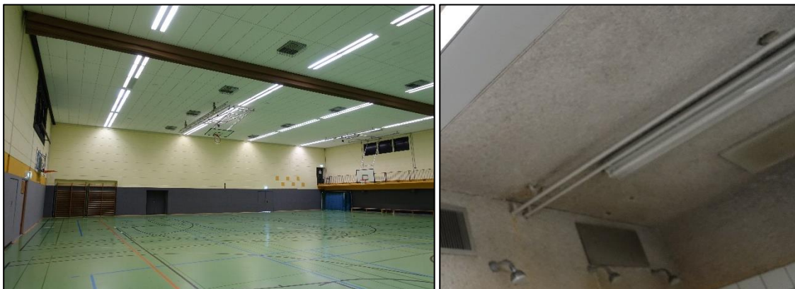
Abbildung 36: Beleuchtung Sporthalle und Duschen mit Leuchtstoffröhren (Annahme EVG)
