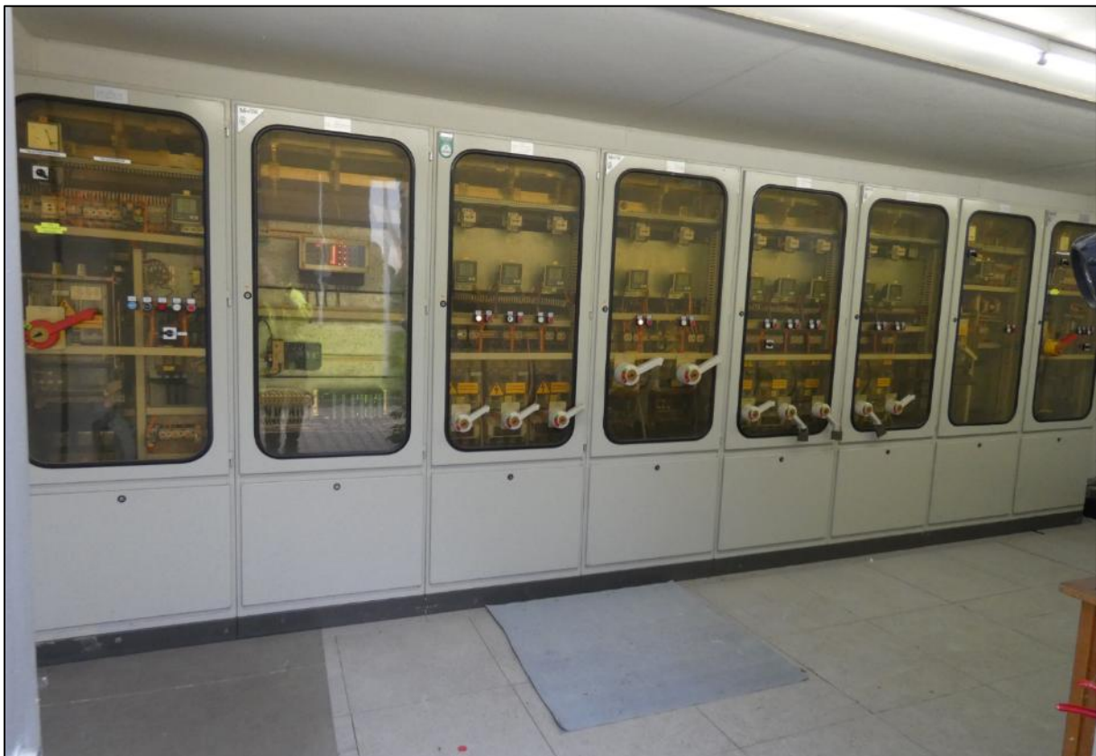
Abbildung 35: NSHV in der Energiestation
