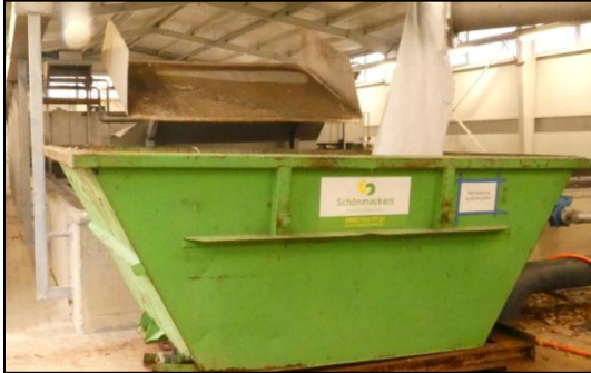
Abbildung 20: Feinrechen und Fettfanggut 1. Seite 7m³
