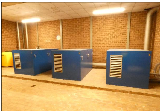
Abbildung 41: Gebäudetechnik Gebläse- und Pumpenraum
