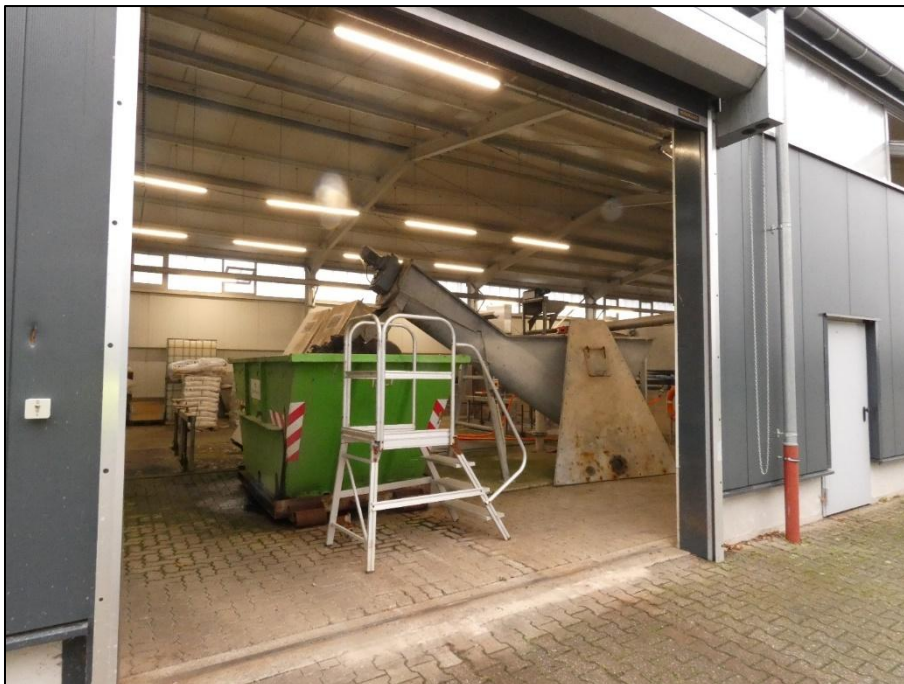
Abbildung 4: Containerstation für Grobrechengut und Sandgut vor Sandfang
