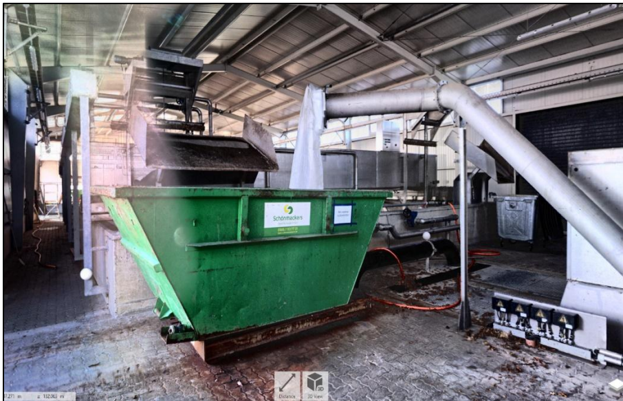
Abbildung 10: Containerstation für Feinrechengut und Fettfang
