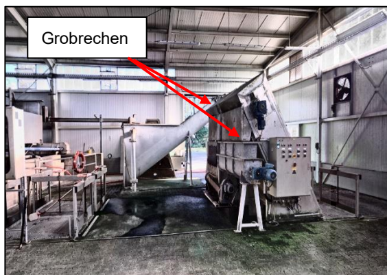
Abbildung 17: Grobrechen vor Sandfang
