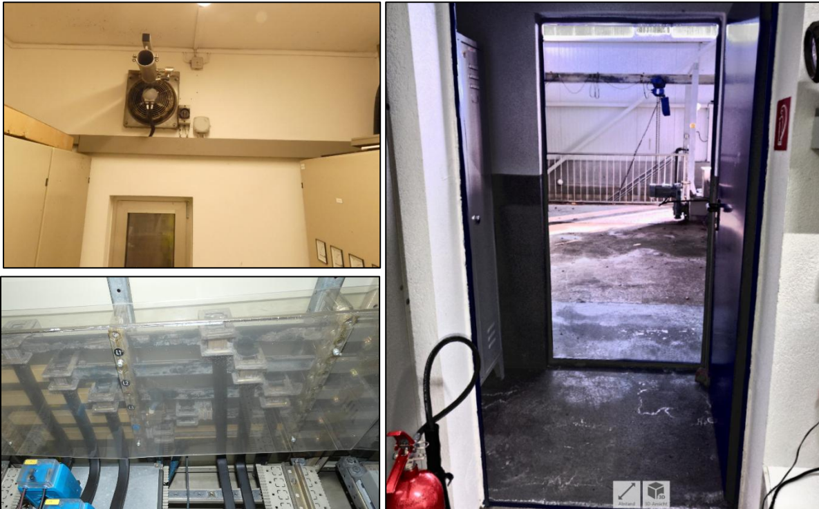
Abbildung 39: Belüftung, Korrosion, Schleuse Schaltanlagenraum Rechengebäude
