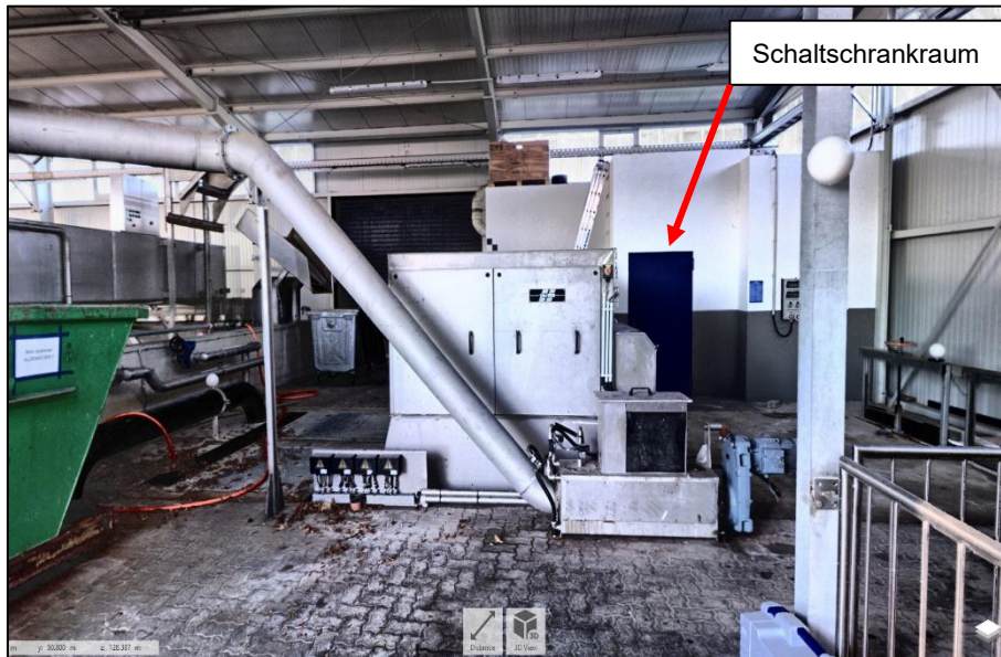
Abbildung 9: Feinrechenanlage Seitenansicht und Schaltschrankraum
