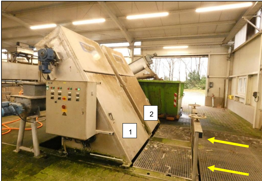
Abbildung 3: Zwei Grobrechen (Harkenumlaufrechen) vor Sandfang
