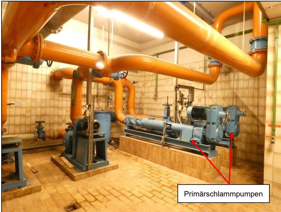
Abbildung 11: Primärschlammumpen im Pumpenraum (UG)
