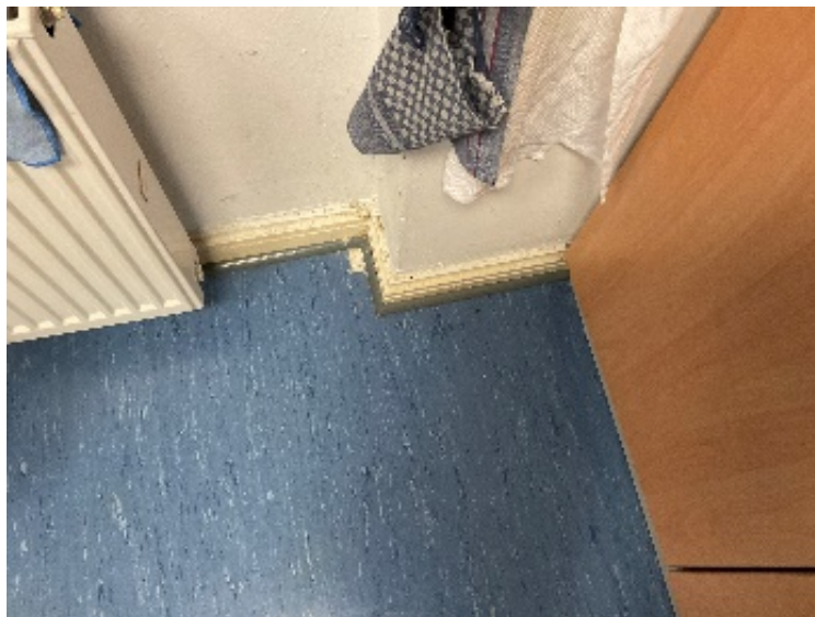
Abbildung 31: Asbesthaltiger Bodenbelagskleber Raum 1032c
