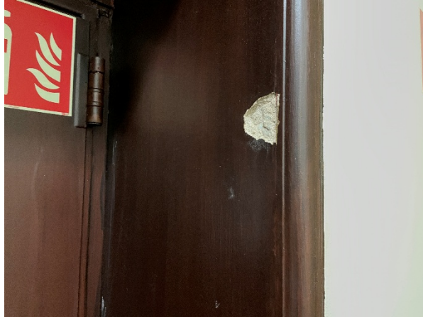
(Beschädigung in der Laibung bereits vorhanden)
