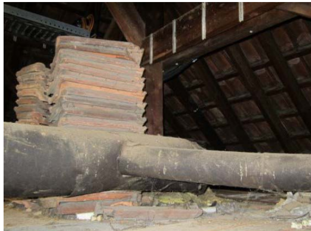
Abbildung 44: KMF Rohrummantelung auf Dachboden
