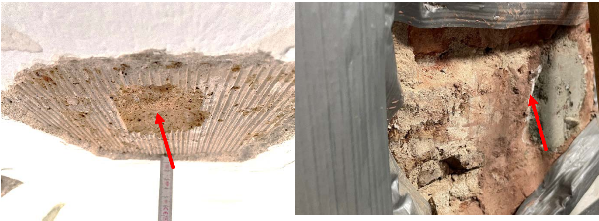
Abbildung 27: Lunker im Decken- und Wandmaterial
