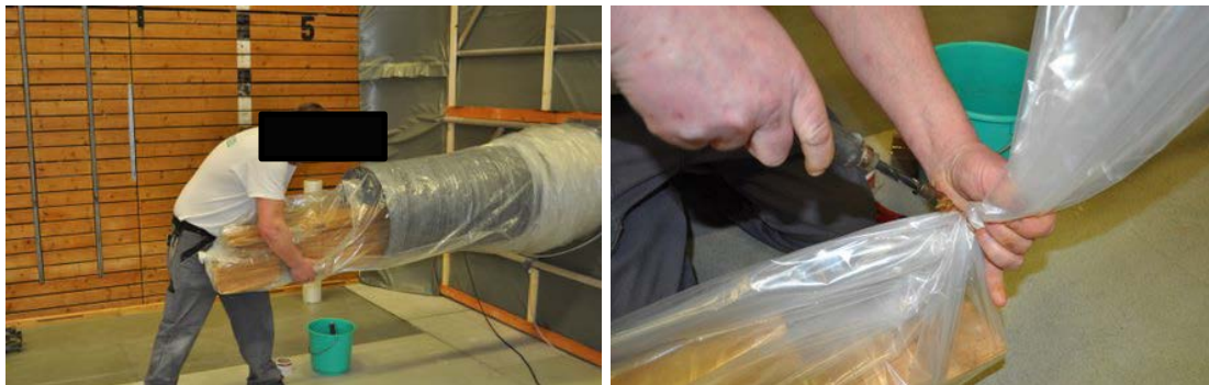
Abbildung 14: Materialrohrschleuse mit Endlosschlauch
