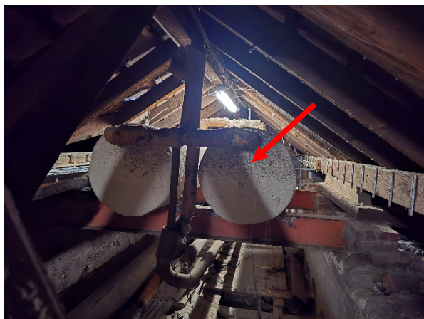
Abbildung 42: Asbesthaltige Isolierung und Leichtbauplatte
