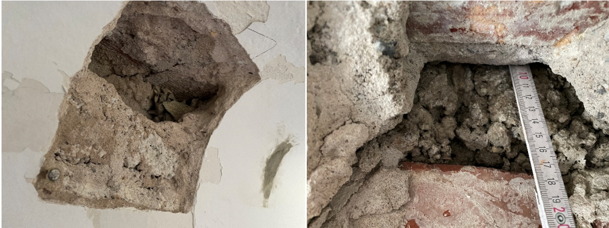
Abbildung 26: Hohlräume im Bereich der Vouten
