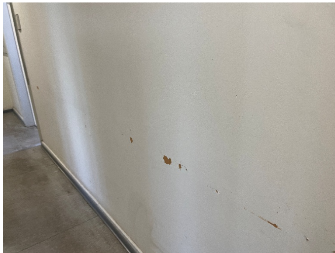
Abbildung 19: Trockenbauwände mit asbesthaltiger Spachtelmasse
