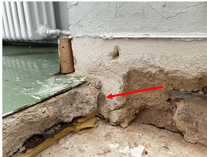
Abbildung 41: Asbesthaltiger Putz bis unter die Estrichlage
