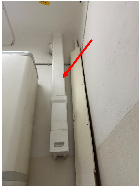
Abbildung 32: Exemplarisch asbesthaltiges Toschi-Rohr, 3. OG
