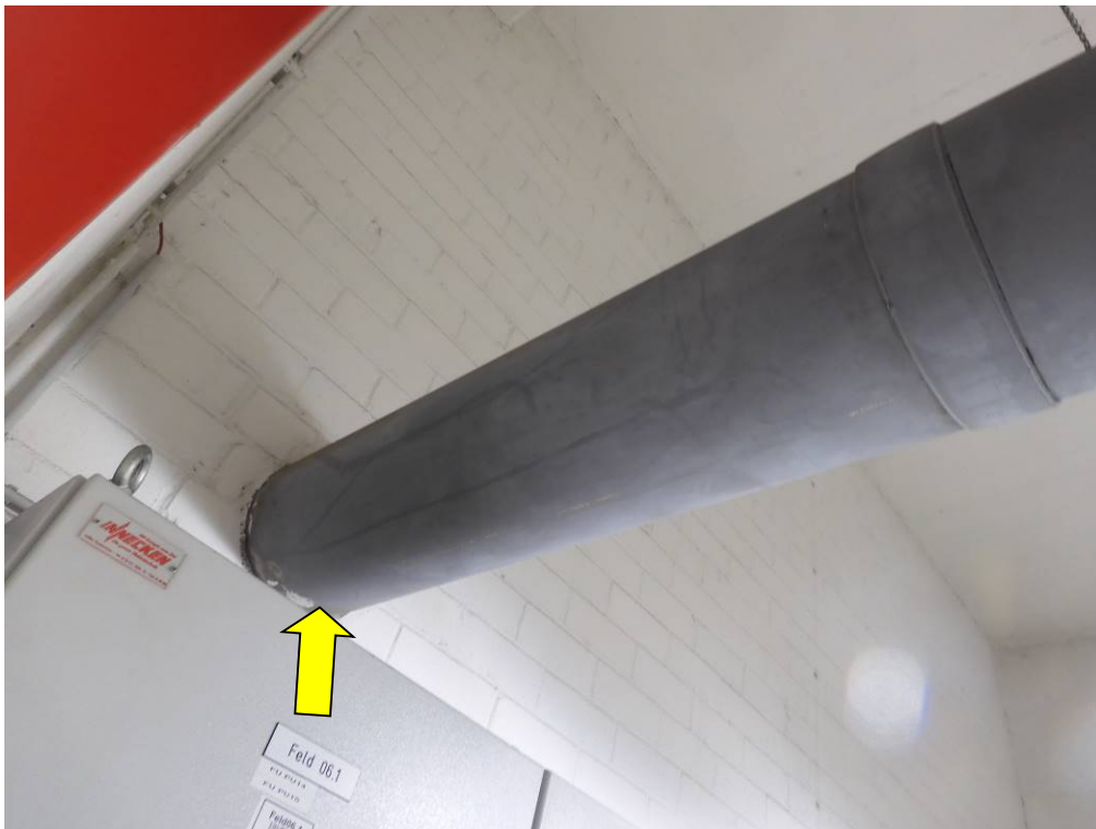
Foto 7: Umluftleitung Raum NSUV Schlammmentwässerung, DN 300, zum Gebläse
