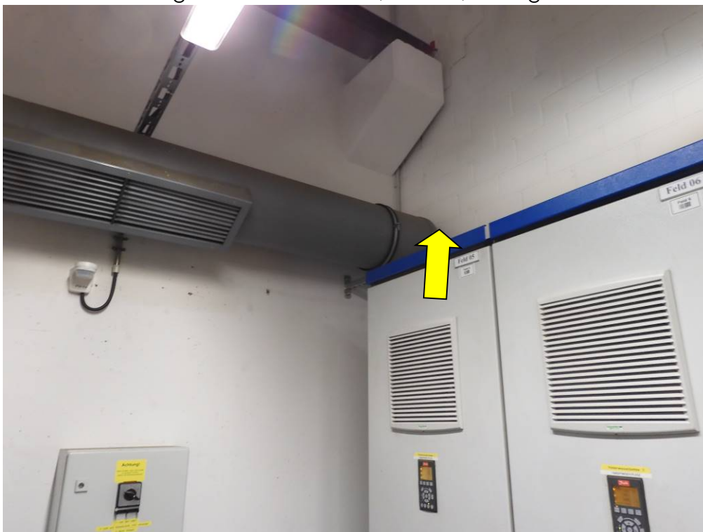
Foto 2: w.v., die Zuluftleitung endet in dem Raum
