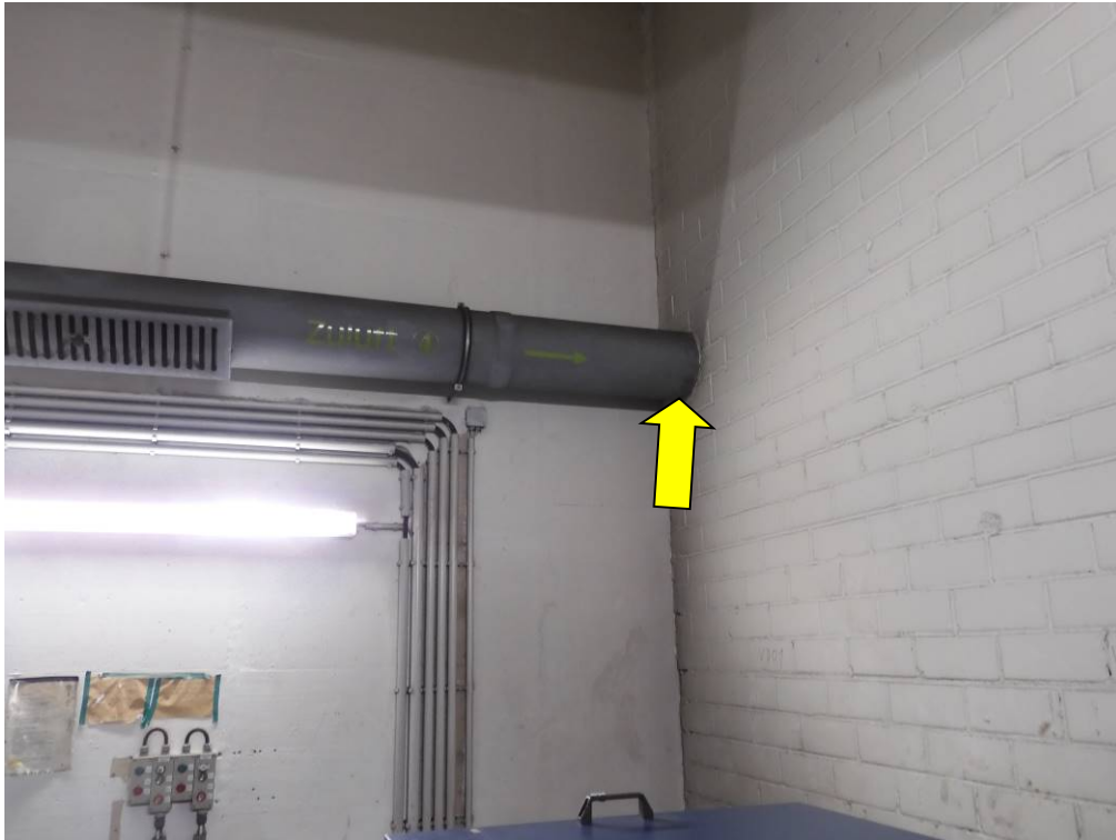
Foto 9: Blick auf die Wand vom Gebläseraum zur NSUV Schlammmentwässerung
