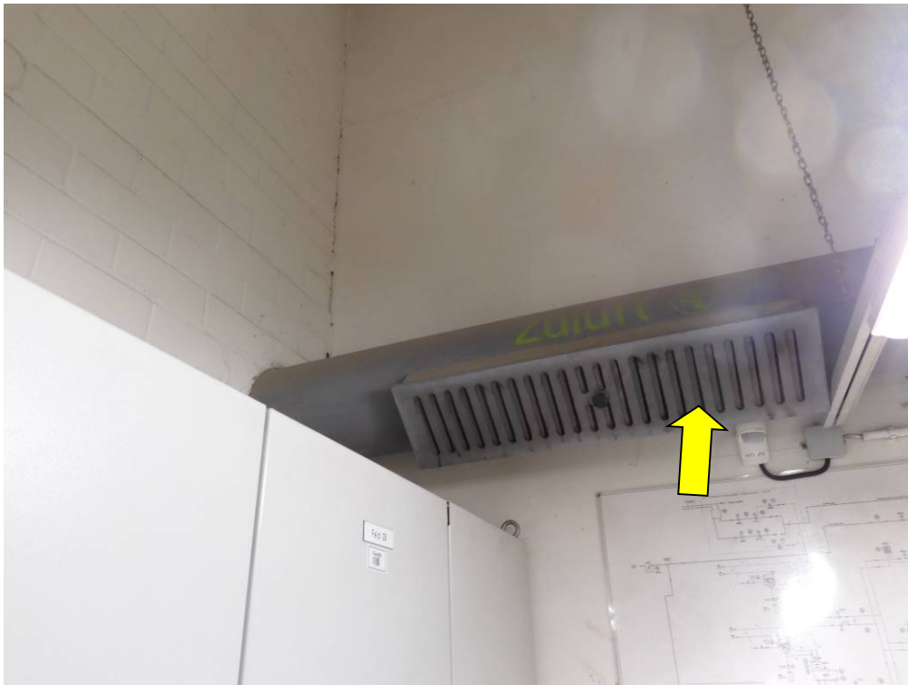
Foto 5: Zuluffleitung Raum NSUV Schlammmentwässerung, DN 300, Lüftergitter
