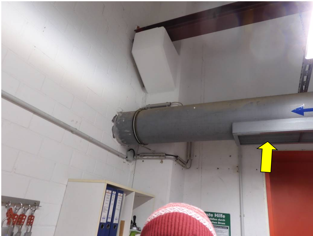
Foto 3: Umluftleitung Raum NSUV PWPW, DN 300, Lüftergitter
