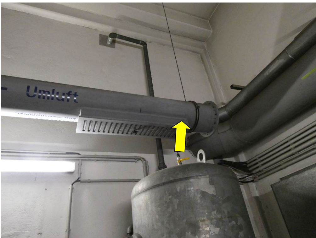
Foto 10: Blick auf die Umluftleitung im Gebläseraum
