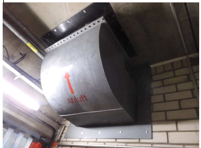
Bild 15: Rohrleitung unterhalb Brandschutzklappe
