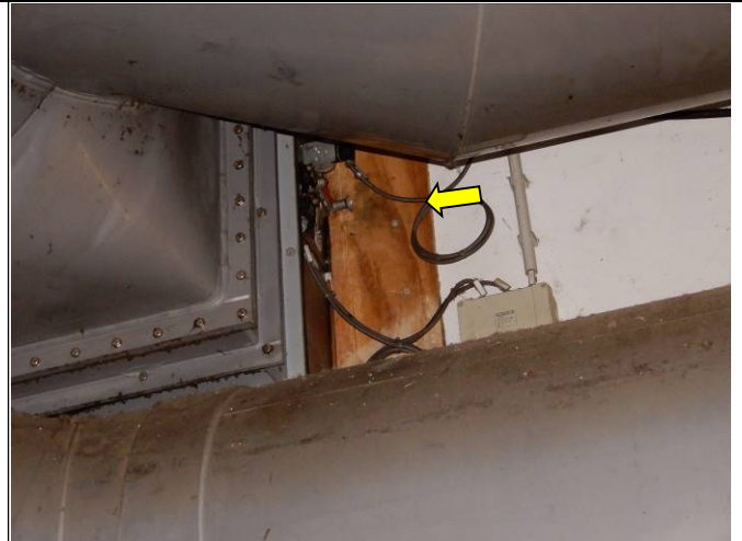
Bild 12: Brandschutzklappe , seitlich Holzbrett
