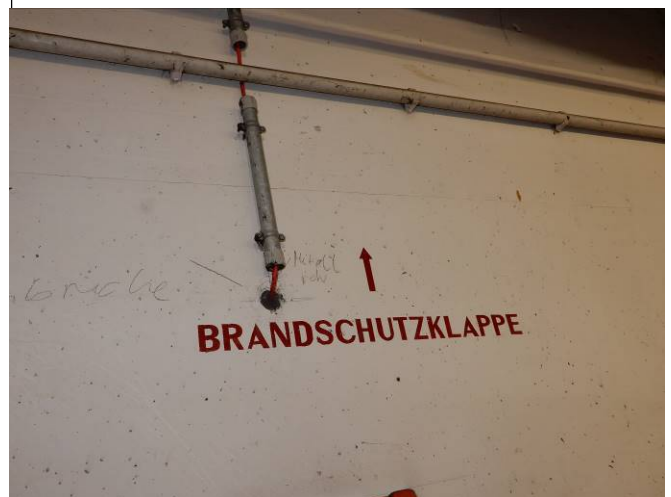
Bild 10 Brandschutzklappe Hinweis an der Wand
