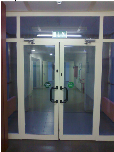
Beispiel: Rauchschutztüren in der Uni Bielefeld
